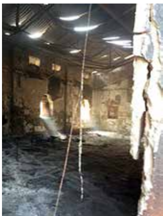
放火により焼失した教会の内部
