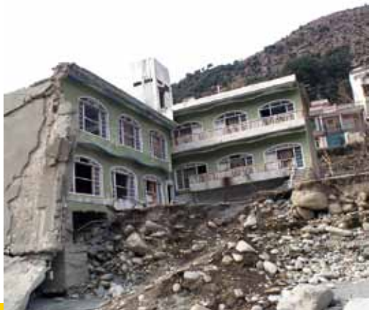
土石流が中に流れ込み使えなくなった建物
